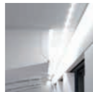
Iluminação interna em LED
