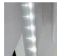
Iluminação interna em LED
